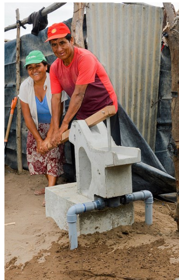
Installation einer Saugdruckpumpe
