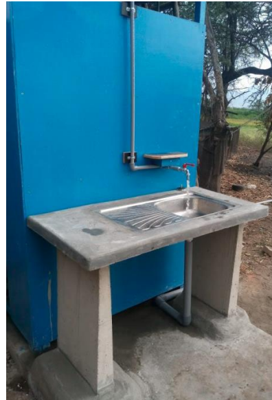
WASH-Installation mit Waschtisch
