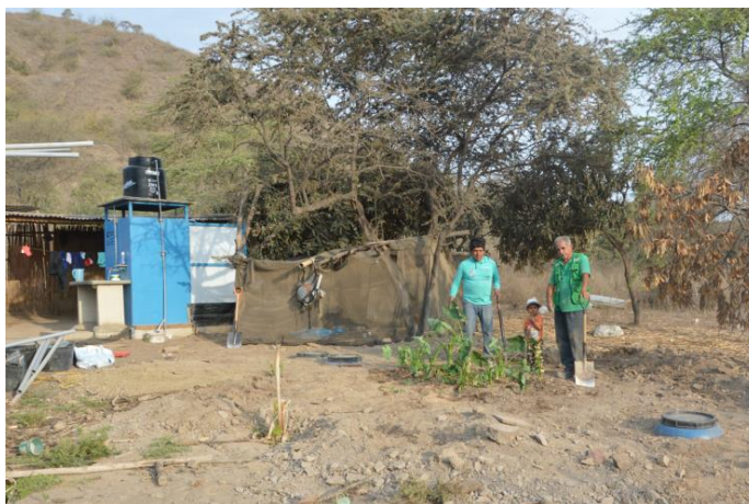
WASH-Installation mit Bio-Kläranlage
